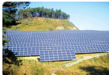
| 경북 예천 1MW 태양광 발전소 |
